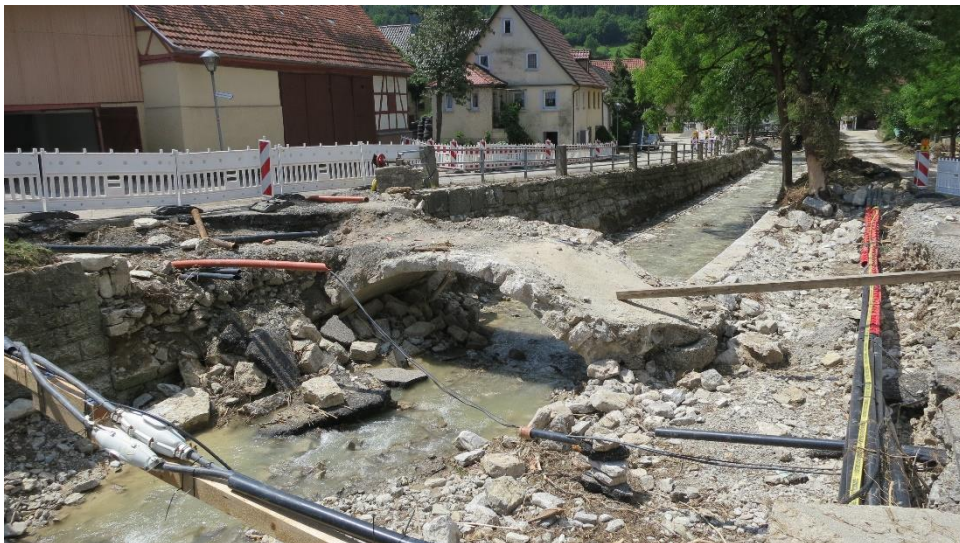
Abbildung 14: Straßenschäden nach Umströmung einer Brücke in Steinkirchen.
