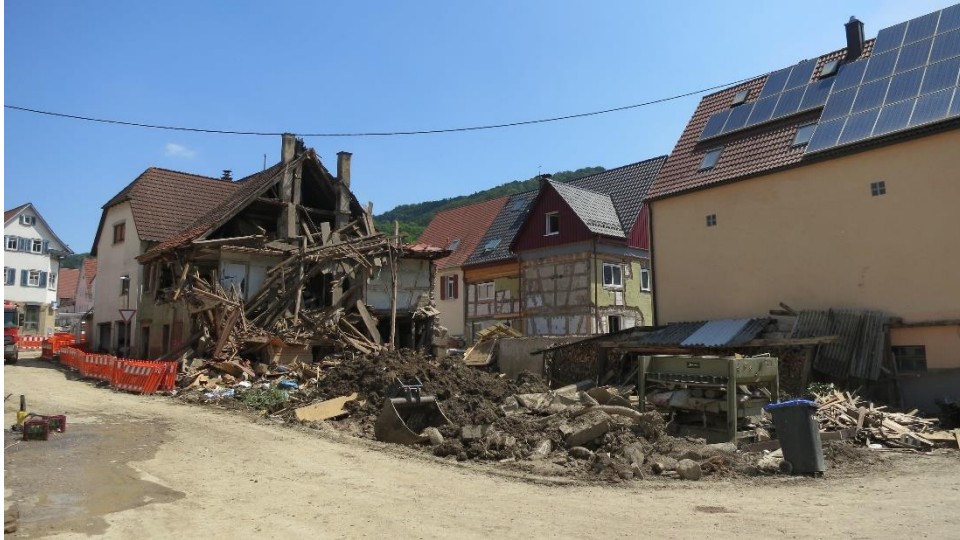
Abbildung 13: Strömungsangriff und Treibgutprall zerstörte Gebäude in Braunsbach.
