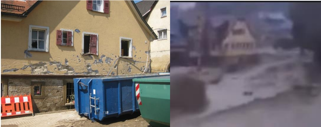
Abbildung 11: Schaden im Erdgeschoss (Souterrain/Tiefparterre) und 1. Obergeschoss (links); Strömungssituation während des Ereignisses mit lokal stark variierenden Wasserständen (rechts).
