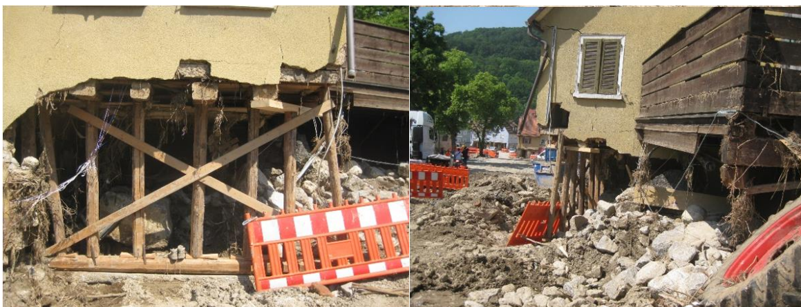
Abbildung 12: Strukturelle Gebäudeschäden in Braunsbach.
